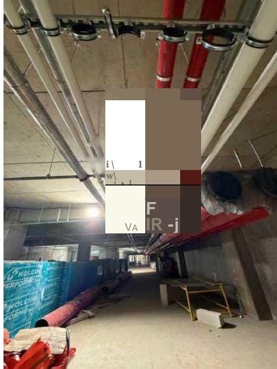
2026.03.21 - Instalatii mecanice si electrice zona TS
